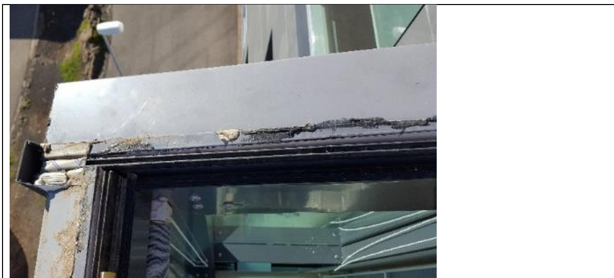
Mynd. Frágangur álkerfis við steipta vegg og glugga er ekki í lagi og veldur lekum innandyrna
