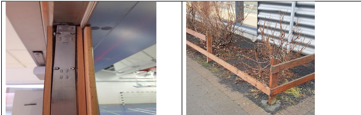
Mynd. Hurðir innanhúss eru margar orðnar lélegar. Girðingar hringum lóð orðnar lélegar.
